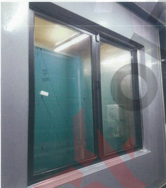
<사진 3> 향온측 시험체 모습 (열관류율)
